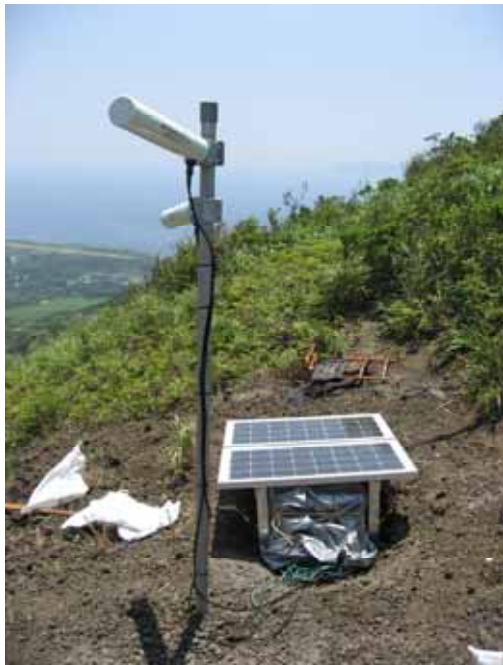
写真 1 無線 LAN 中継点外観
