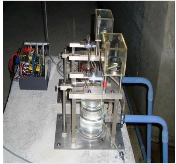
● 伊佐観測室坑道：水管傾斜計 W1A/W3B
