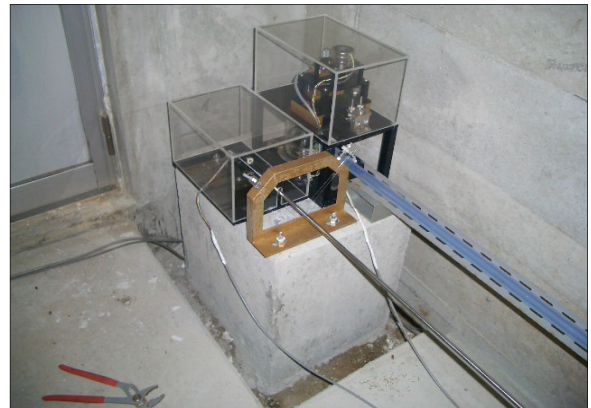
● 傾斜計・伸縮計センサー部
