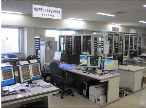
Figure 4 サーバルーム
