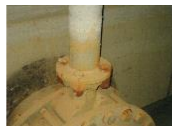
写真3 ボルトの錆状況
