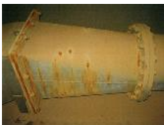
写真1 メンテナンス前の様子
