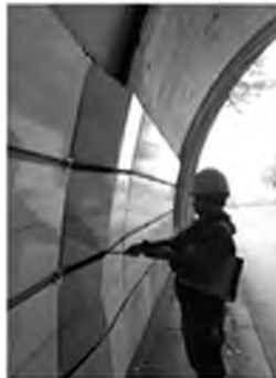
写真11 依山トンネル内の右横ずれ変位
