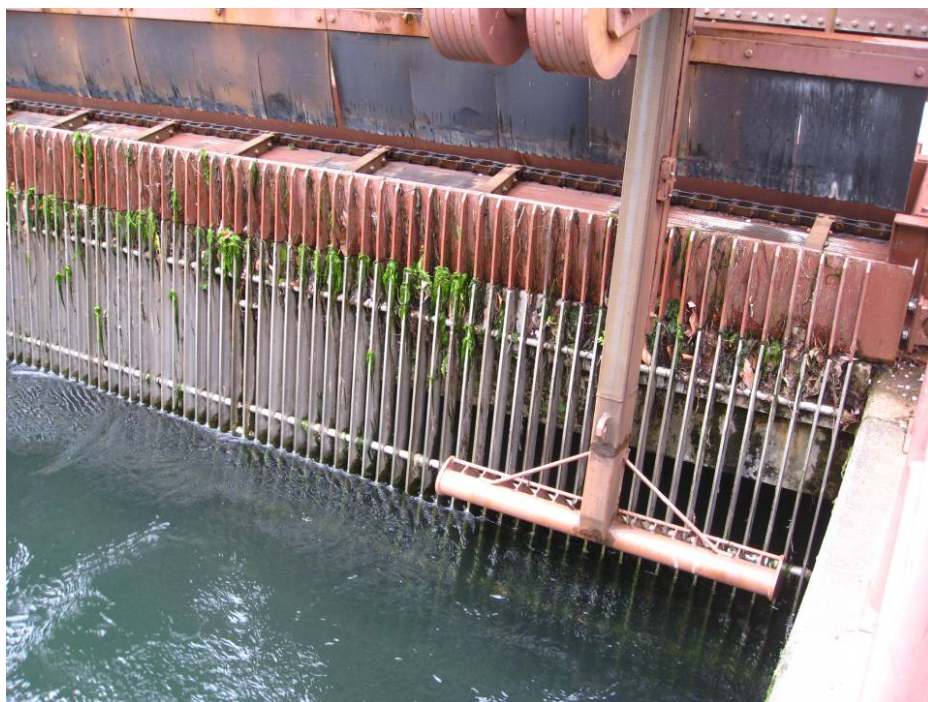
図3-2 蹴上水力発電所取水口のスクリーンと除塵機
