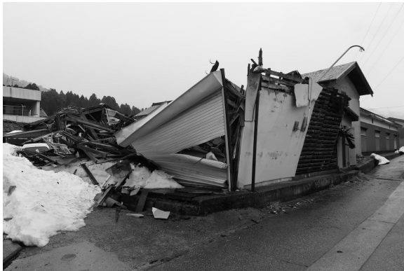
写真-2 勝山市の空き工場の倒壊状況 (3月9日調査)
