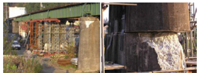
写真-1 新潟県中越地震で被災した魚野川橋梁 4)
