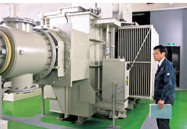
77,000Vの高圧電力を受電し、降圧する装置。地下の約300㎡ほどの広い空間に配置されている
