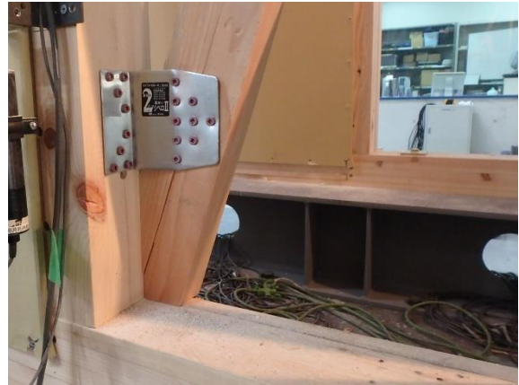
d) 筋交い端部の割れ 試験体 WB, 加振 No.5 後
