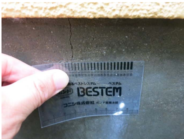
基礎のクラック
