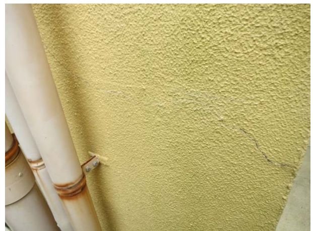
北東キッチン裏外壁のクラック
