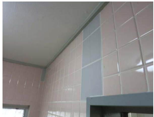
洗面室タイル割れ
