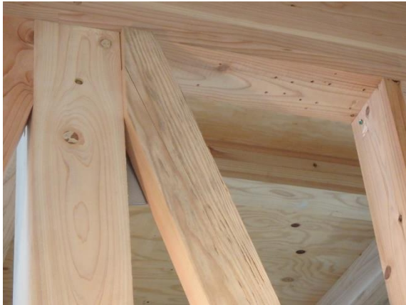
c) 筋交い端部の割れ・ズレ 試験体 WB, 加振 No.4 後
