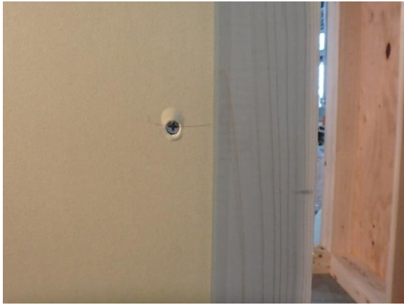
a) PBビス部の浮き 試験体 SD, 加振 No.4 後
