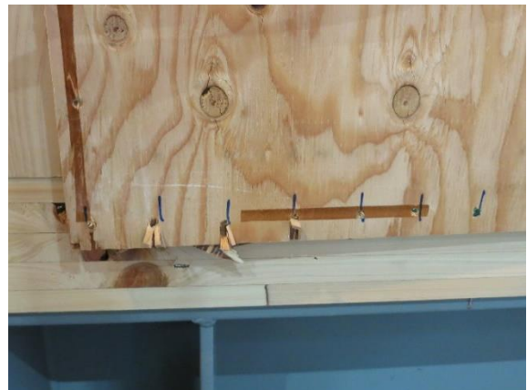
f) 合板端部の端抜け 試験体 PW, 加振 No.5 後
