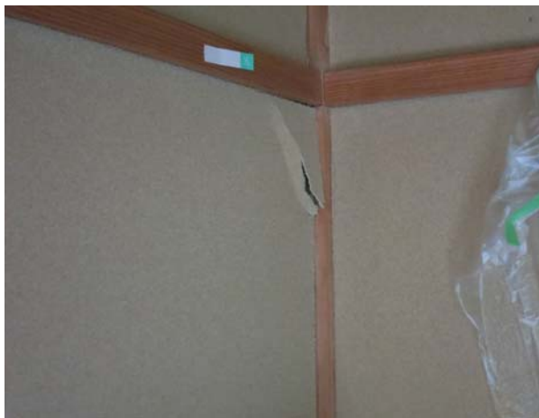
内装下地の損傷（南西隅）
