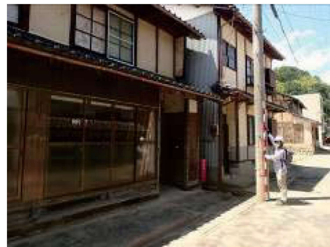
図-2 2.7mの浸水痕跡が見られた住宅
