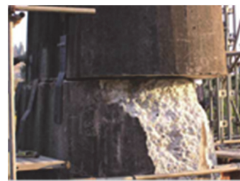
写真-1 2004年新潟県中越地震で被災した魚野川橋梁14P橋脚 4)
