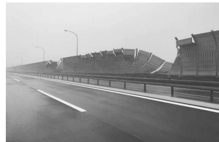
図 43 遮音壁の損傷
