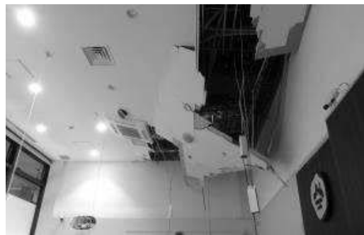
図 25 ビル室内の天井の脱落
