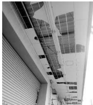
図 26 ビルの軒の天井の脱落
