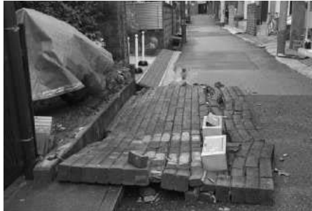
図 38 コンクリートブロック塀の倒壊
