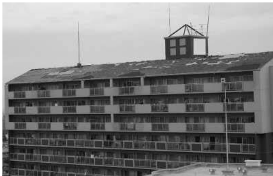
図 21 マンションの屋根葺き材の飛散
