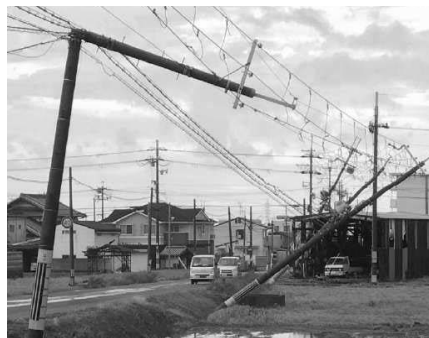
図 48 電力施設の被害
