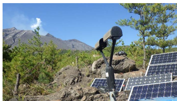
図1. ディストロメータの設置状況
