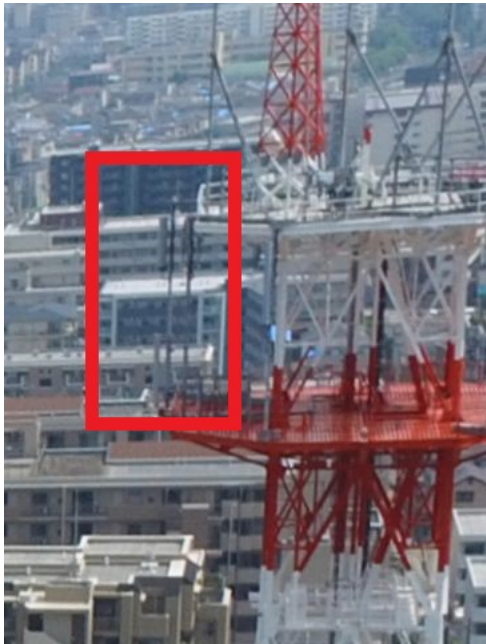
写真 2 携帯基地局アンテナ
