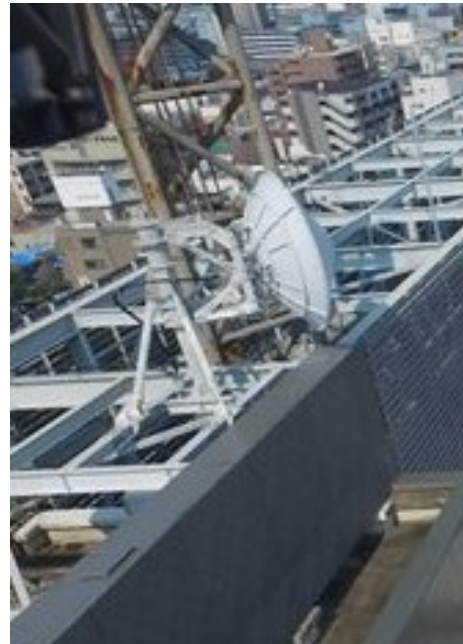
写真 3 パラボラアンテナ
