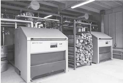
黄金泉に設置されている VISSMAN 社薪ボイラ
