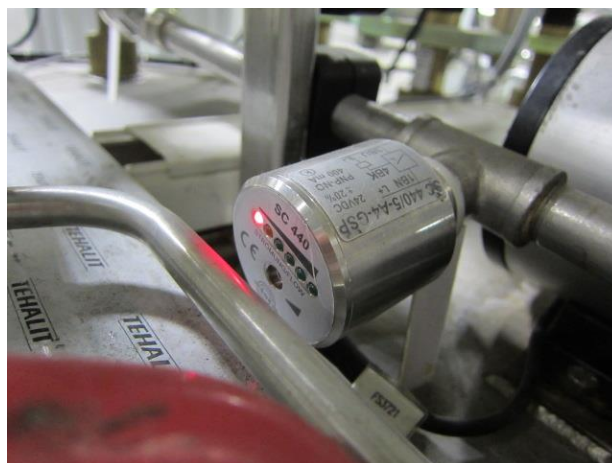
図 1. 破損した冷却水流量センサー。フロントパネルの流量表示は冷却水の流量不足を示している。
