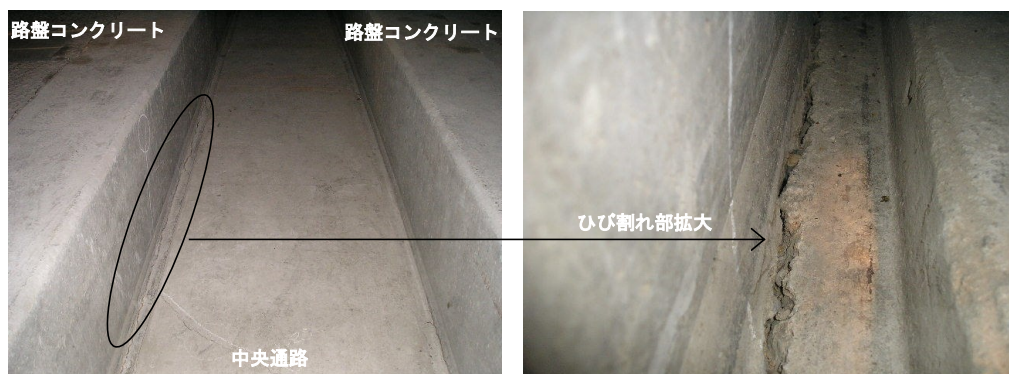
写真-3.1 中央通路部のひび割れ
