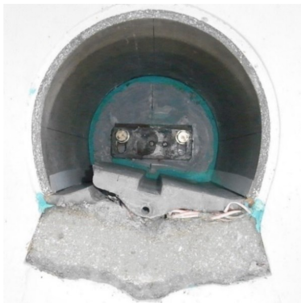
写真-6.7 盤ぶくれ状況 (実験完了時: I_{NAiP} )
