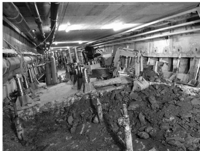
図-2.36 キーエンベルグトンネルでの盤ぶくれ状況 56)
