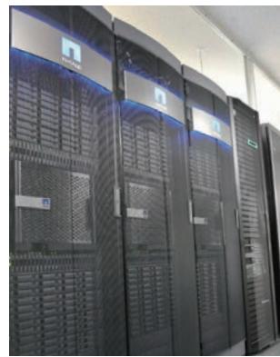
ユーザデータやゲノムネットデータベースを保持する大容量ネットワークファイルシステム
