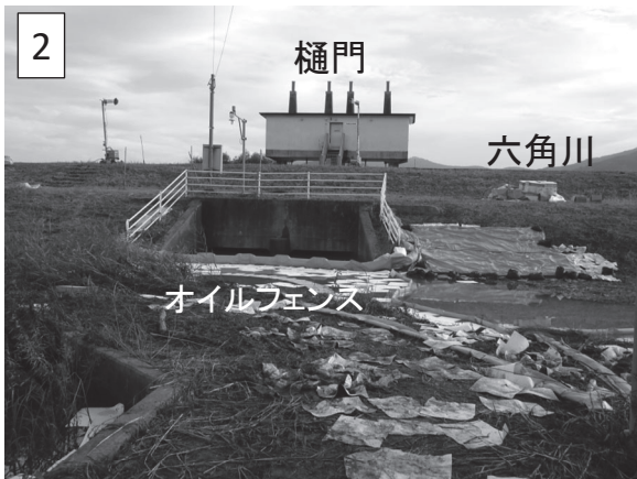
写真3 佐賀鉄工所から流出した油の吸着マットによる撤去 (1)，樋門の閉鎖とオイルフェンスの設置による六角川への油の流入防止 (2) (2019年9月2日撮影)
