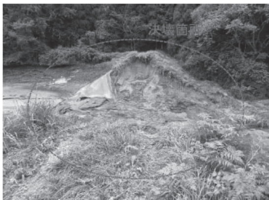
図 9 宮城県逆川上溜池の決壊状況（農林水産省提供）
