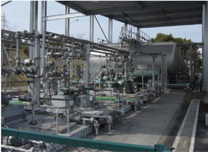
タンクヤード
