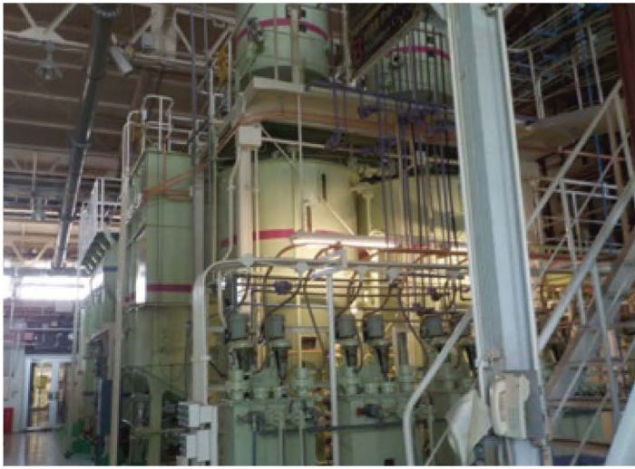
廃棄物処理棟内の処理装置
