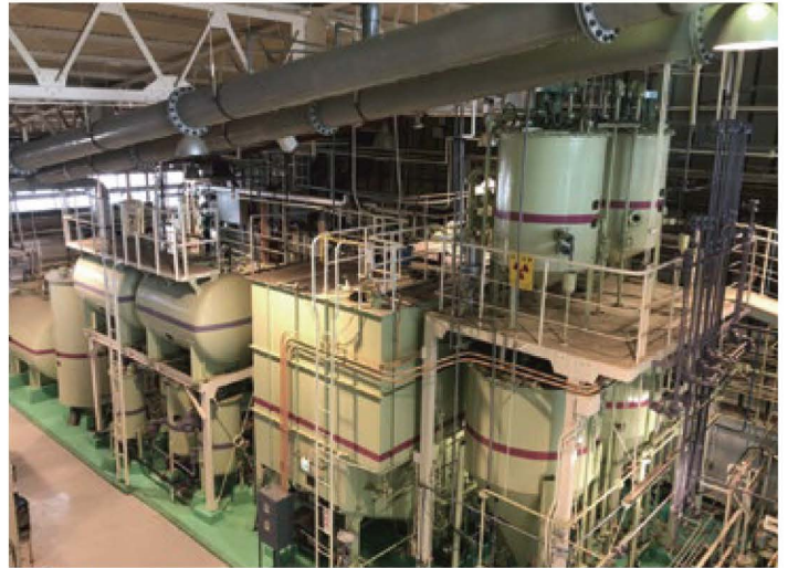
廃棄物処理棟内の処理装置
