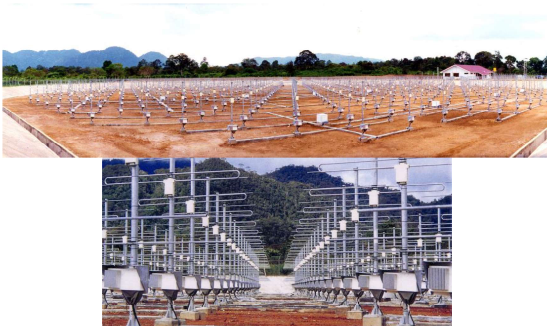
図 9 赤道大気レーダーの全景(上図)及びアンテナ近景(下図)
