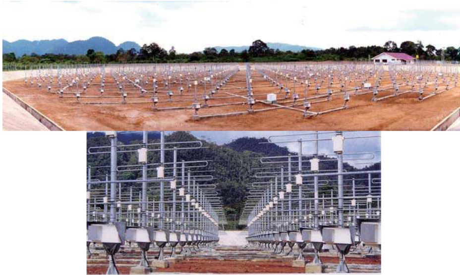
図 2.6 赤道大気レーダーの全景(上図)及びアンテナ近景(下図)
