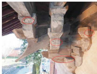
図4-2：中国伝統建物斗拱部材の欠点探査
