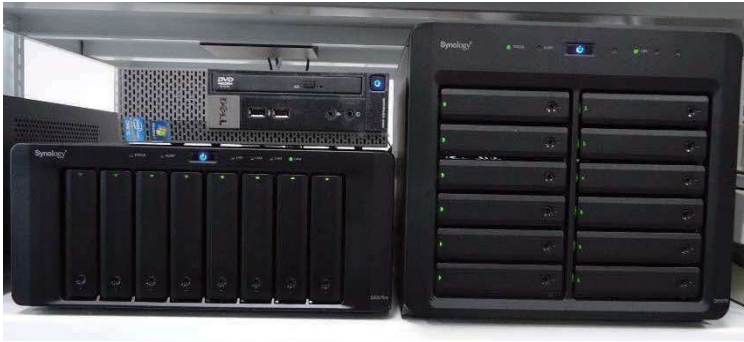
図2 ミラーリングサーバー (8TBx 20 台の RAID)
