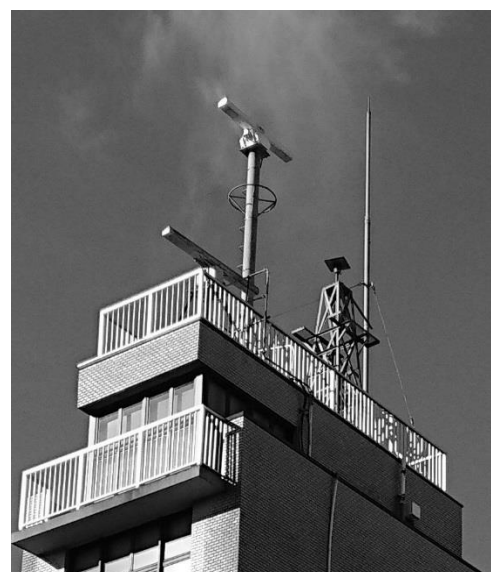
写真 2 鹿大水産学部に設置されている船舶レーダ
