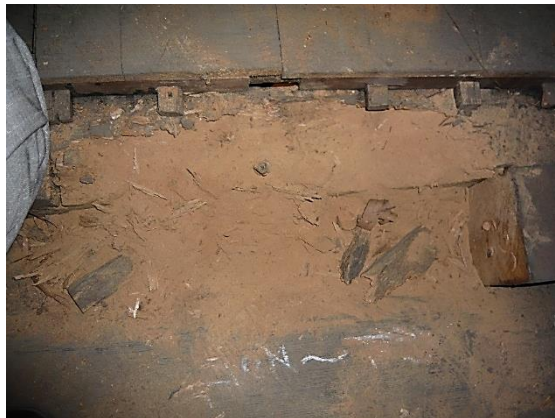
図 2-8 天井部分の被害の様子
