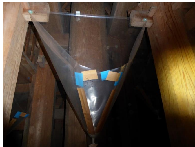
図 4-12 FIT 設置の様子
