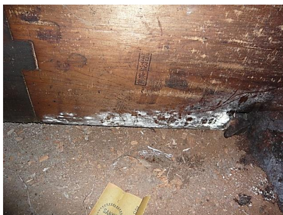
図 2-10 被害材に発生しているカビの様子
