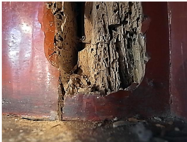
図 2-23 中禅寺立木観音堂の柱の被害
