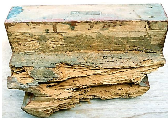
図 2-3 被害材 {当初材(下部)と1961年に継いだ材(上部)}
