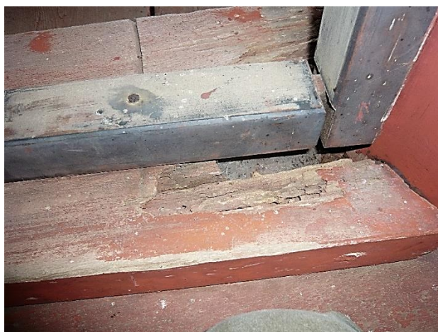
図 2-25 中禅寺鐘楼の被害の様子
