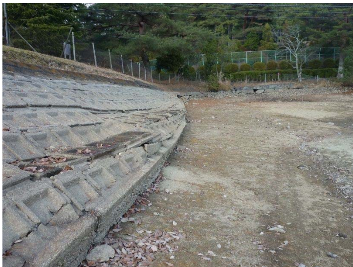
図-2.8 兵庫県南部地震により法面保護工が変形したため池写真（著者撮影）
