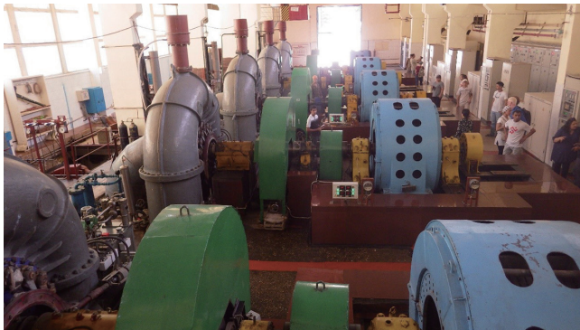
写真⑦ 「パミール・エナジー」本社敷地内にあるホーローグ水力発電所のタービン（2018年8月7日、筆者撮影）
