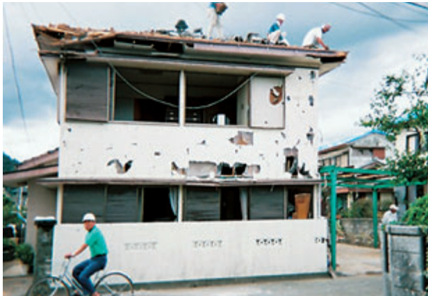
写真3 飛来物による外壁・開口部の破損
