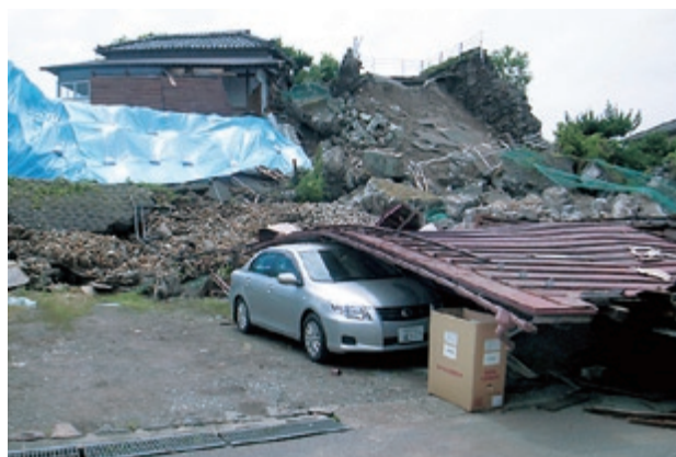
写真1 新砂丘海側斜面における「崖っぶち」の崩壊
