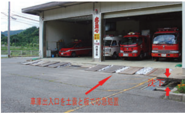
写真1：図2中のD1（門前町防災センター）の地盤沈下状況
