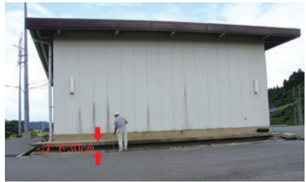
写真2：同防災センター側面の地盤沈下状況
