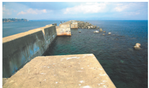
写真 2 伏木富山港ケーソン式防波堤の滑動被災状況
