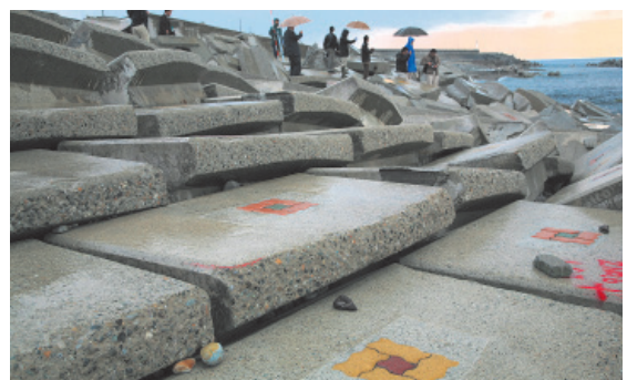
写真 1 入善町芦崎地区の被災した緩傾斜護岸
