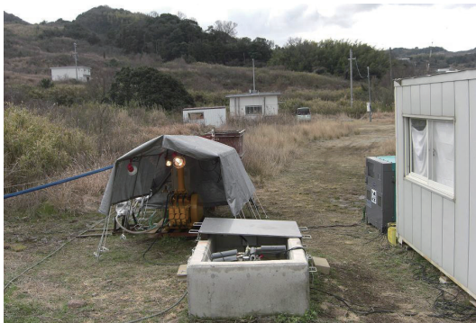
第6回注水実験の様子（2009年1月～3月）。手前の1,800m孔口の向こうにポンプと水槽が、また右手に注水制御・データ収録用プレハブと発電機が設置され、遠方の建物は観測室および人工振動発生装置
