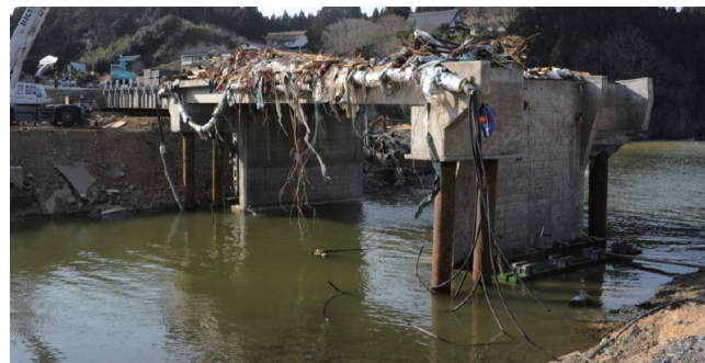
写真8 橋梁の裏込土の流出
