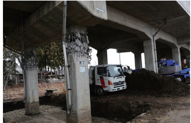
写真2 軸力支持能力を喪失するほど破壊された柱
