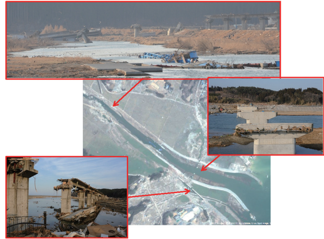
写真6 河川を遡上した津波による橋梁被害（気仙沼・本吉）
