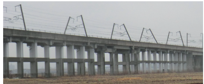
写真3 新幹線電化柱の損傷
