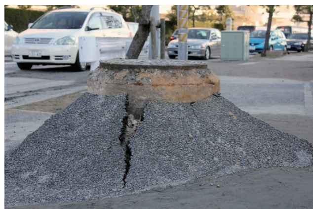
写真7 浮上ったマンホール
