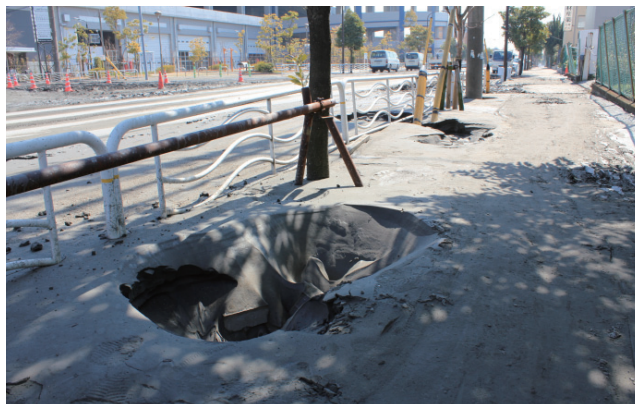
写真1 歩道に堆積した噴砂
