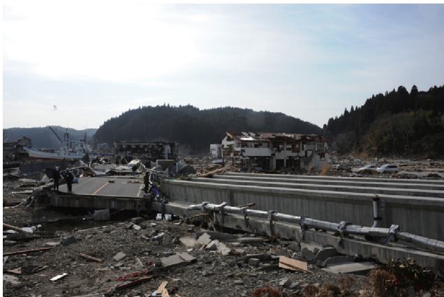
写真5 歌津地区のコンクリート橋の流出
