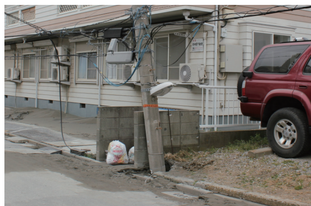
写真6 沈下した電信柱
