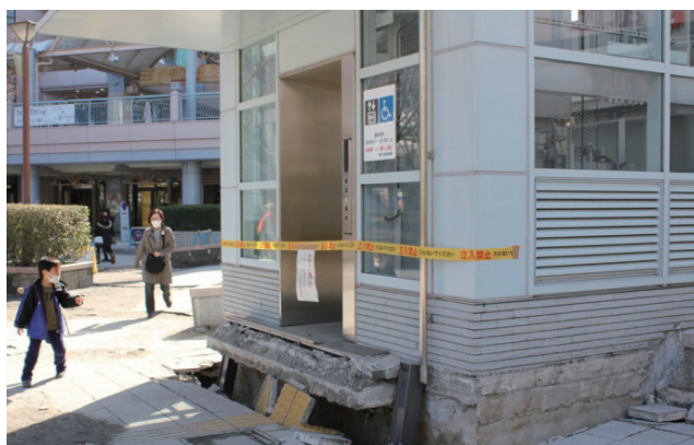
写真2 周辺地盤の沈下による段差
