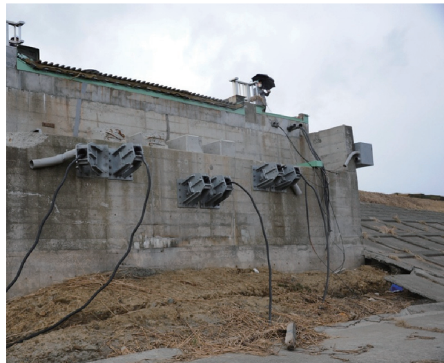
写真7 引きちぎられた落橋防止構造（新北上大橋）
