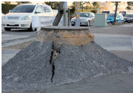
液状化により浮上ったマンホール (P11)
