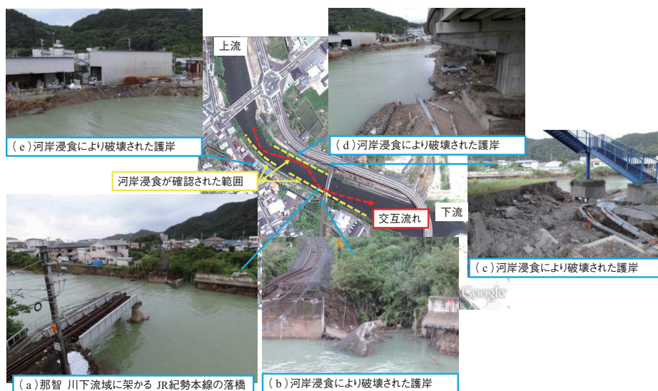
写真2 那智川下流に架かる JR 紀勢本線の橋周辺の被災状況
