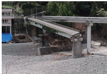
折立橋の落橋（奈良県十津川村） （P11）
