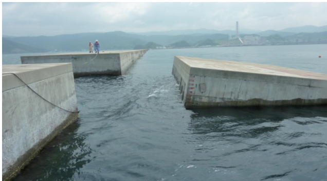
写真1 福井県敦賀港における防波堤の被害 (国土交通省港湾局海岸・防災課提供)
