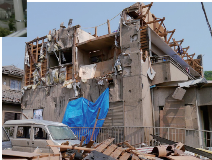
写真2 破壊された住家
