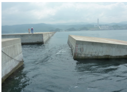
福井県敦賀港における防波堤の被害 (P6)
