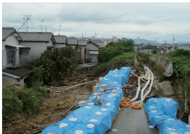
写真1 弥陀次郎川の破堤箇所全景 (8月15日)
