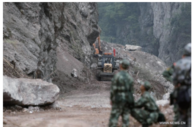
写真2 雅安地震による道路法面の崩壊。このような崩壊が道路を寸断した( www.news.cn )。
