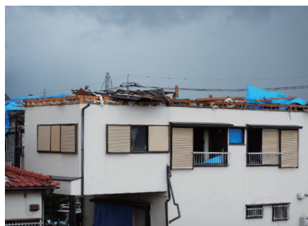
竜巻で吹き飛ばされた小屋組み (P5)
