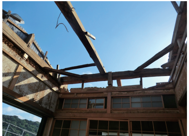
写真1 田並地区で屋根が完全に破壊された家屋
