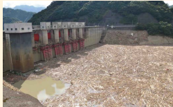
2011年紀伊半島水害時の流木流入(橋山ダム)
