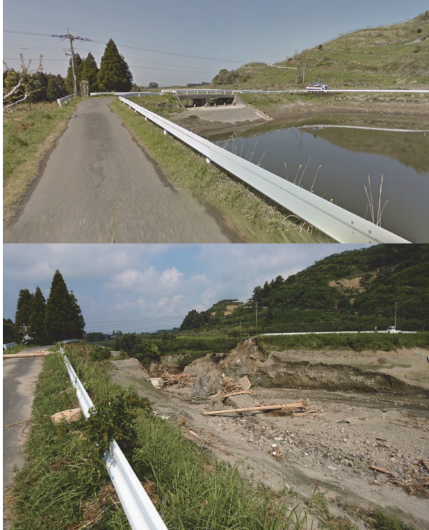
図3-2 決壊した山の神ため池(奈良ヶ谷川) 上:決壊前(Google Earthより)、下:決壊後
