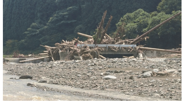
図3-3 流木で閉塞した橋梁(寺内ダム上流・黒川)
