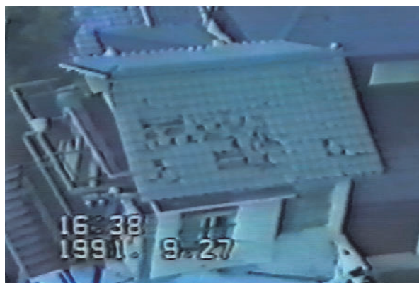
図2 住宅の瓦屋根の強風被害の様子を上方から撮影した映像
