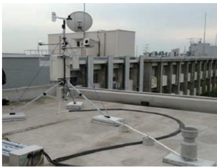
防災研究所屋上での気象観測 Meteorological observation on the roof of DPRI
