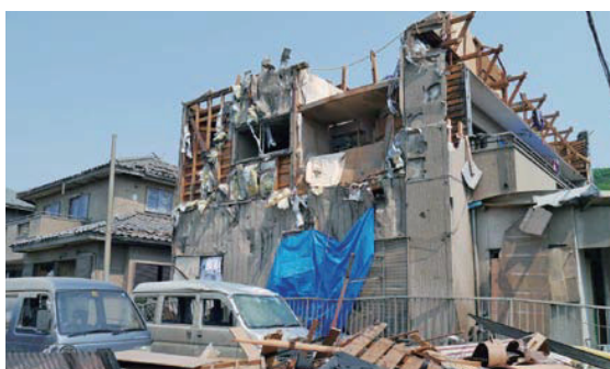
強風により被害を受けた住宅 Houses damaged by strong winds
