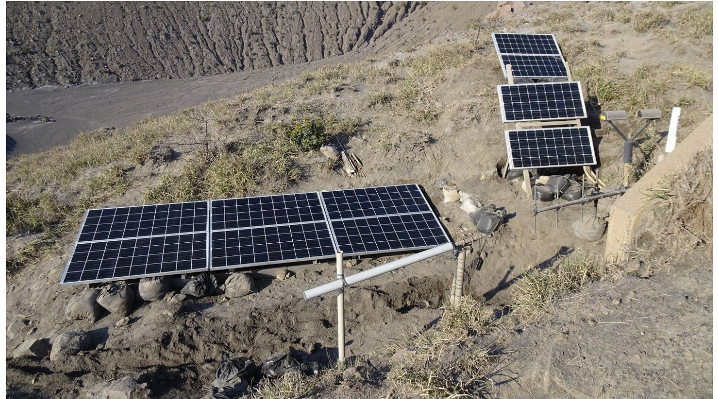
強靱化後の引ノ平観測点ソーラーパネル配置状況。
