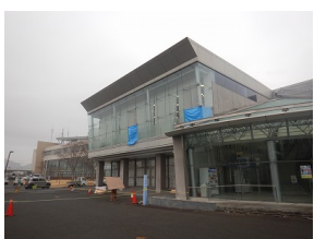
写真8 ガラスの被害*
