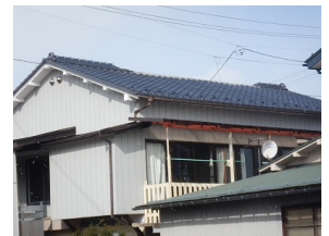
写真20 瓦屋根の被害
