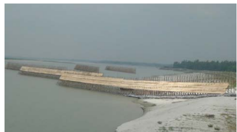
バングラデシュ国のジャムナ川に設置したバンダル型水制（カジプール地点）
