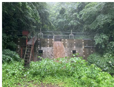
ヒル谷に設置された試験堰堤
