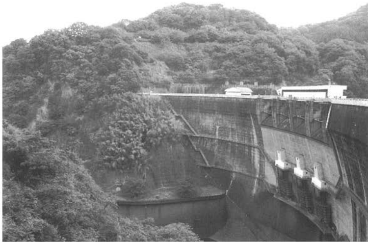
写真Ⅲ-2 天ヶ瀬ダム。右岸急斜面に流れ壁での滑落跡が見える。ダム取り付け箇所の上流側面管理道路の上の斜面も不安定で、それが張り出す。ダム堤体の各所に水のしみ出し痕が白く見える。
