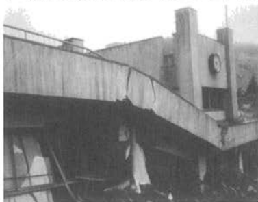
c：流され折れた小学校校舎
