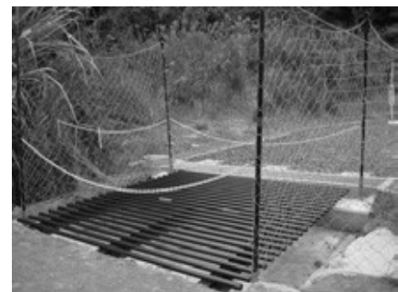
写真-2 設置状況
