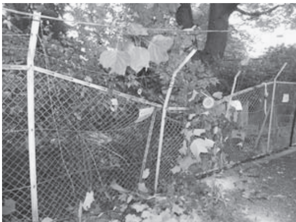
ケヤキの落枝で破損したフェンス
