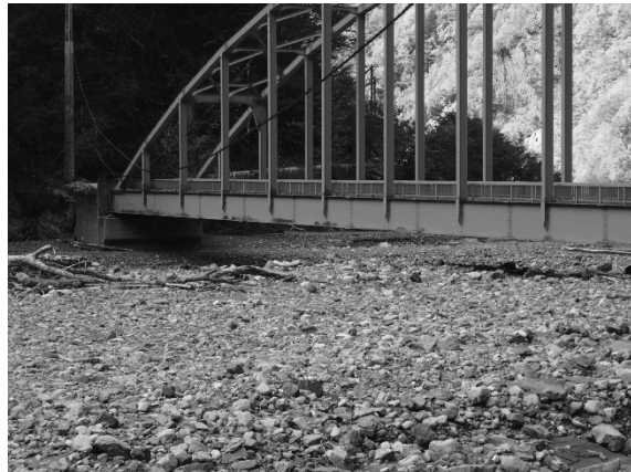
写真 4 橋桁に迫る堆積土砂
